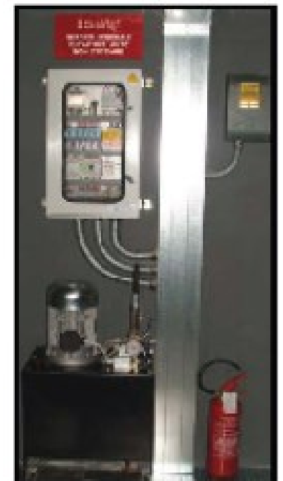
Centrale hydraulique et tableau électrique d'un monte voitures IdéalPark (Photo non contractuelle).
